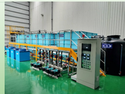
MBBR 廢水處理系統
