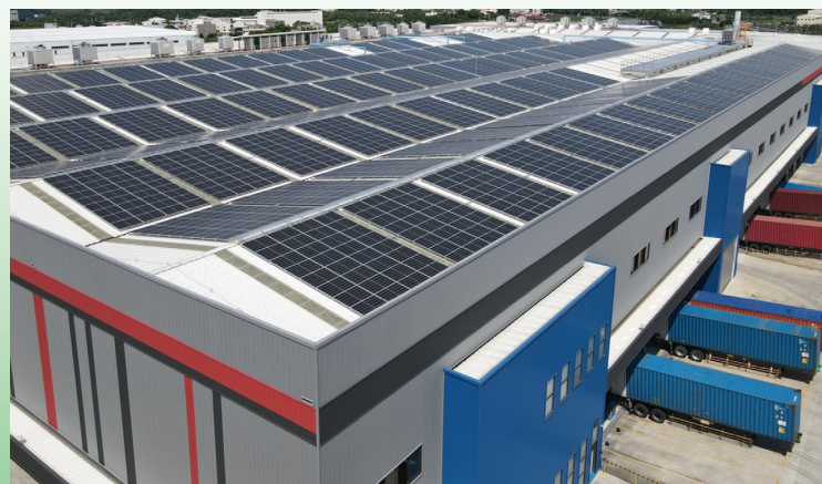
廠區屋頂型太陽能
