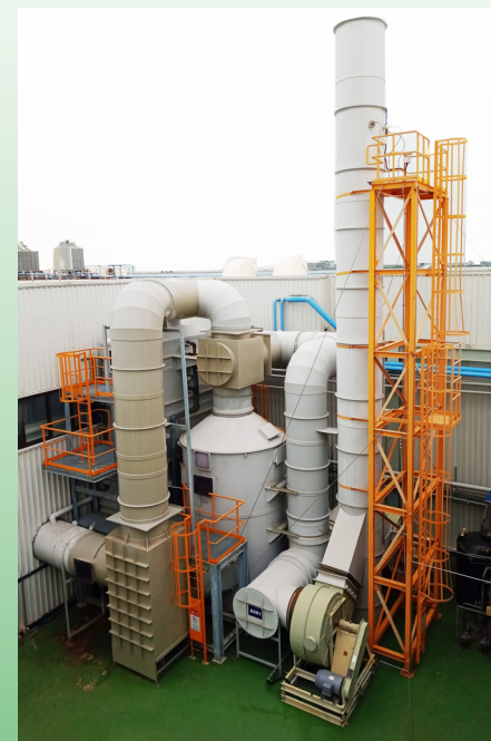
洗滌塔濕式處理設備
