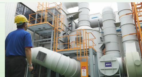
洗滌塔濕式處理設備
