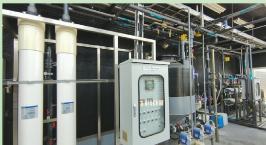
生活污水處理系統
